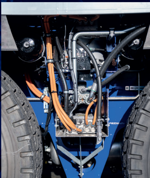
Generatore sulla gru AC 4.070HL-1
