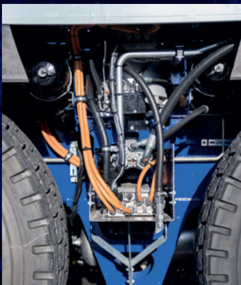
Generador en la AC 4.070HL-1
